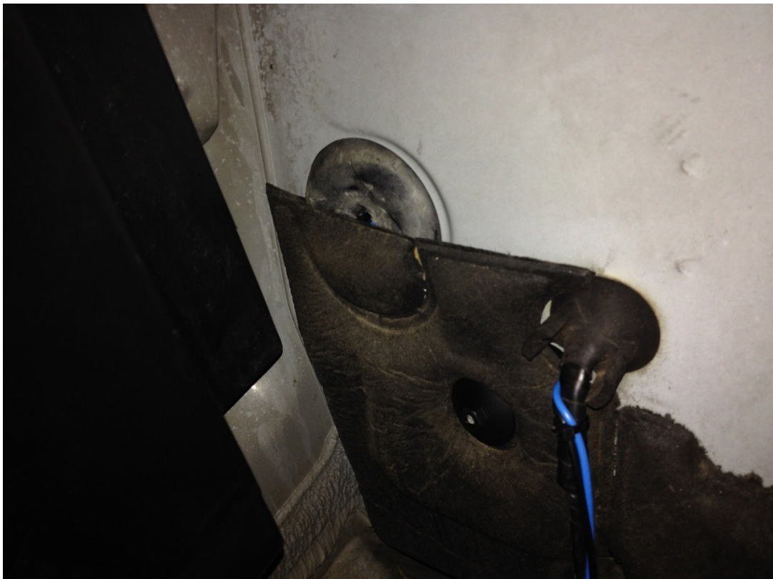
nieuwe bekabeling aan de motorzijde van het schutbord
